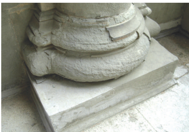
Илл. 177 а -б. Техническое состояние баз в лоджии
