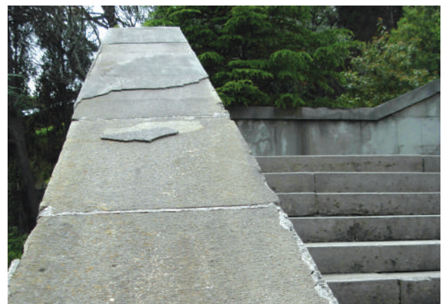
Илл. 178. Состояние венчающего карниза парапета западной лестницы
