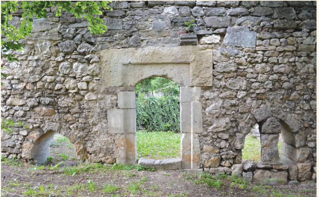
Разрушенная церковь в Старом Крыму. Южный вход снаружи.
